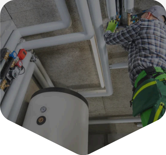
Doğalgaz Tesisatı ve Proje
